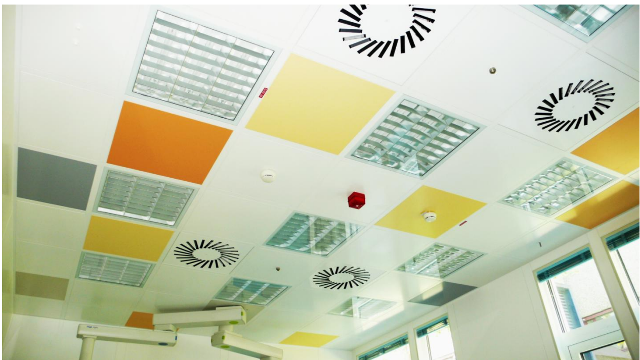
Deckenplatten in verschiedenen Farben mit Luftauslässen und Leuchten in RR-Decke
