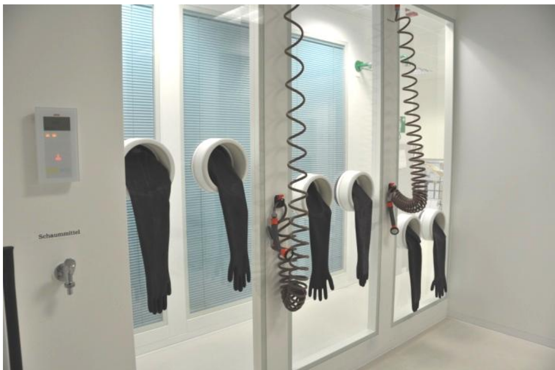
Mittellichtelemente mit Glovebox Handschuhen im Dekontaminationsbereich
