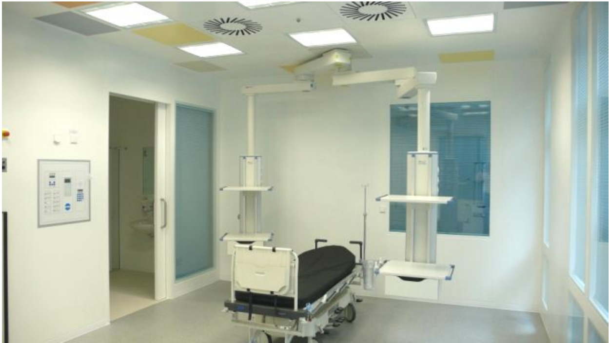
Krankenzimmer mit Reinraumdecke, Reinraumwänden und Schiebetür Typ S50
