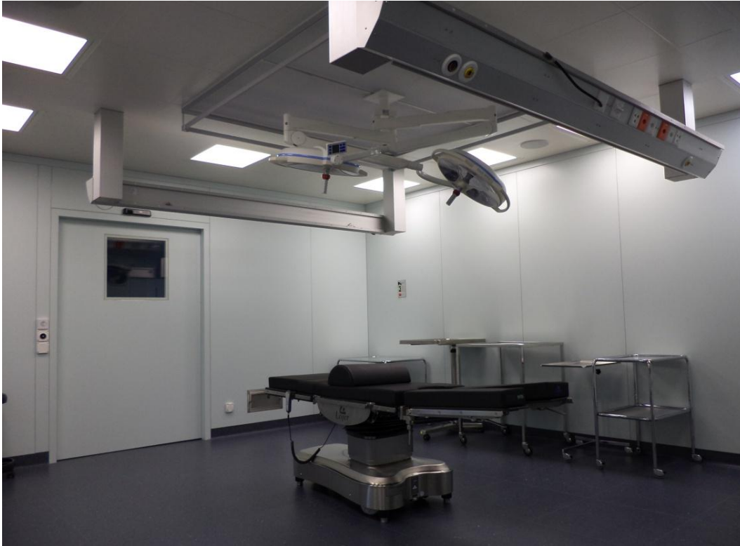
OP-Saal mit OP-Tisch, Deckenversorgungseinheit, Laminarflow-Decke und automatisierter OP-Schiebetür
