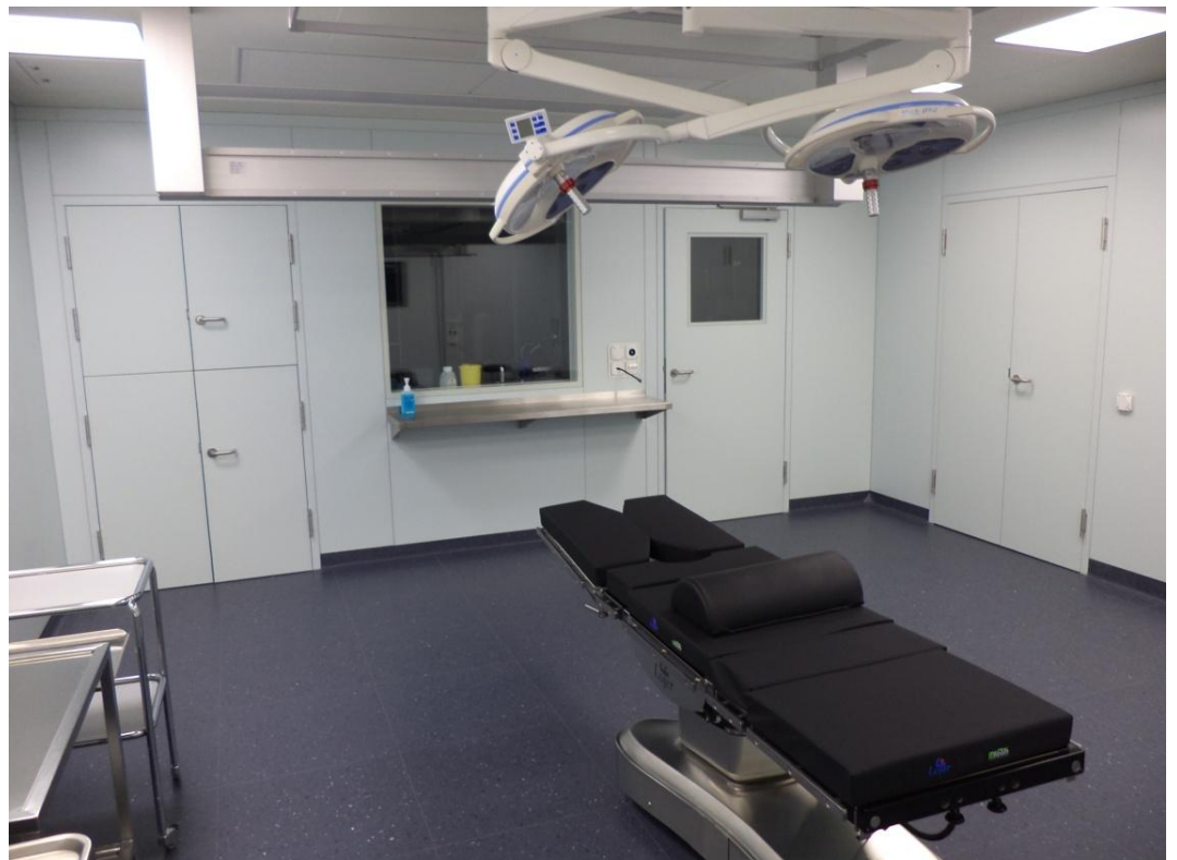
OP-Saal mit OP-Tisch, Deckenversorgungseinheit, OP-Einbauschränke und OP-Drehtür
