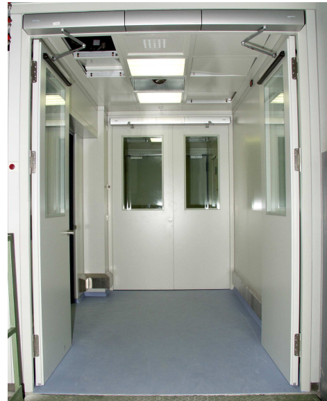
Materialschleuse: 2-flügelige Drehtür mit automatischem Antrieb
