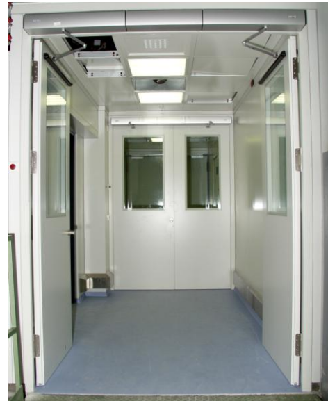
Materialschleuse: 2-flügelige Drehtür mit automatischem Antrieb
